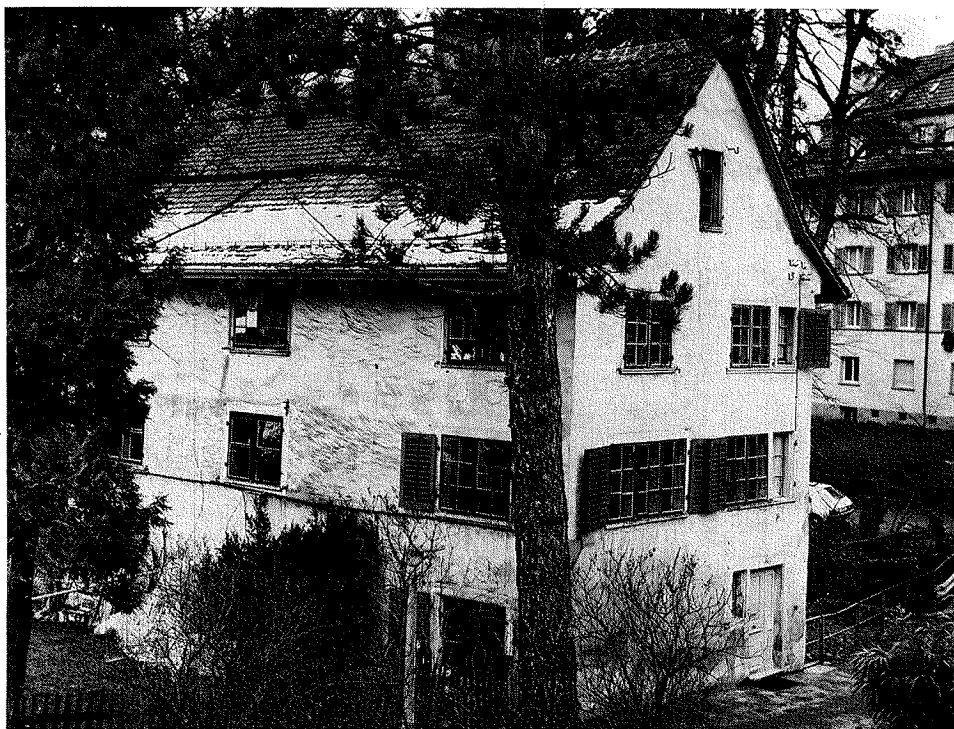
Drahtzugstrasse 72. Im ersten Stock befinden sich Werkstatt Räume, im zweiten Stock Büros.
